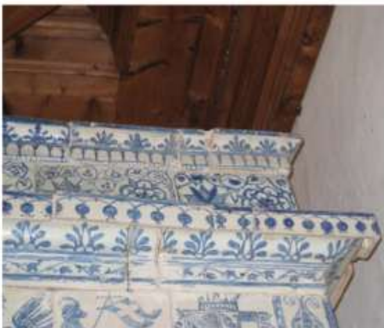
Apparentemente la stufa si presentava in discrete condizioni ma è invece evidente lo stato assolutamente precario di diverse piastrelle.
